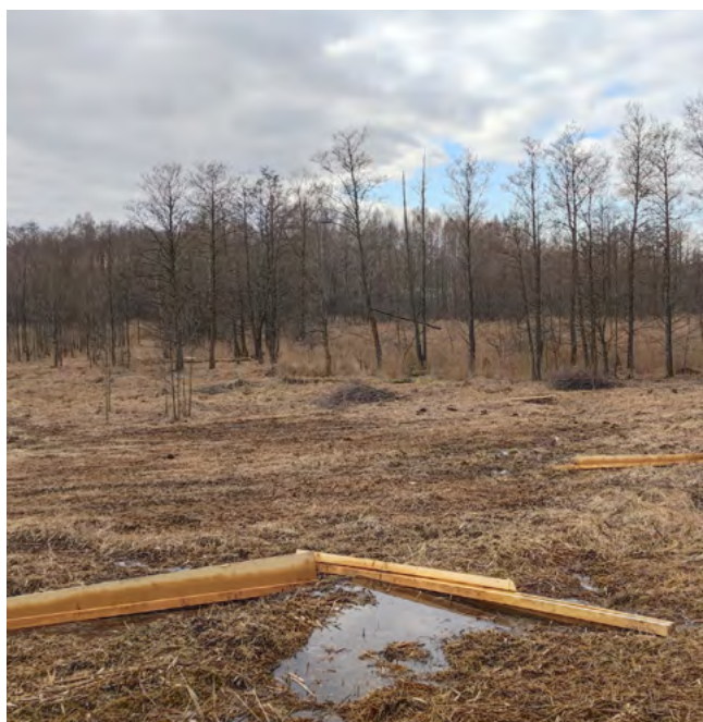
Pelkę sausinantys grioviai patvenkti įvairių konstrukcijų vandenį sulaikančiomis užtūromis. Hidrologinis režimas pagerintas 11 ha plote.
